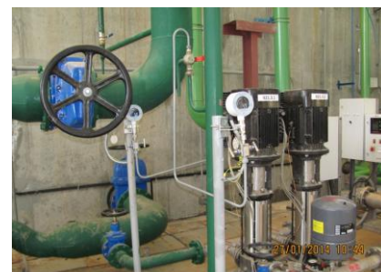
АСУ канализационной насосной станции.
